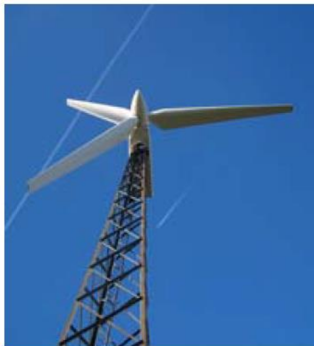
Figura 17 - Turbina eólica intermediária (CEPEL, 2010).
